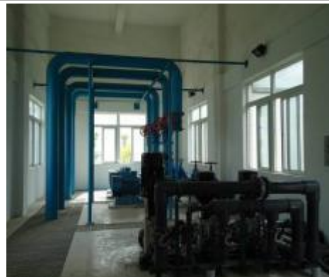
回用水供水泵房
