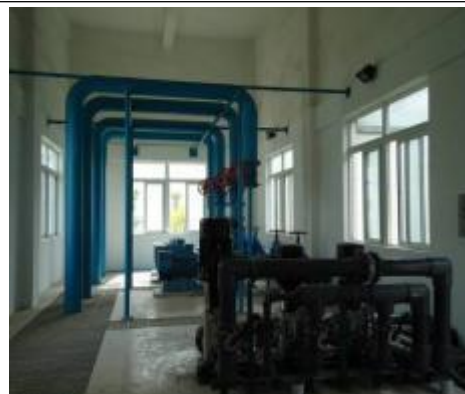
回用水供水泵房
